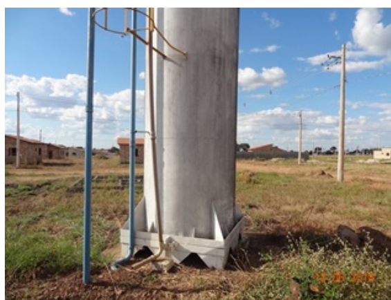
Foto 2 - REL do Setor Abdala Abrão sem cerca de proteção (falta urbanizar).
