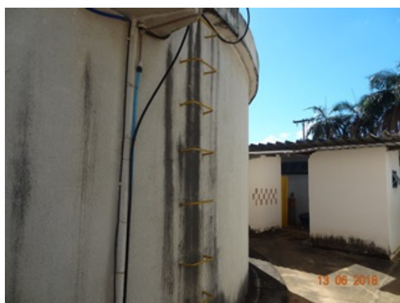
Foto 1 - RSE do C.R. sem guarda-corpos na escada.
