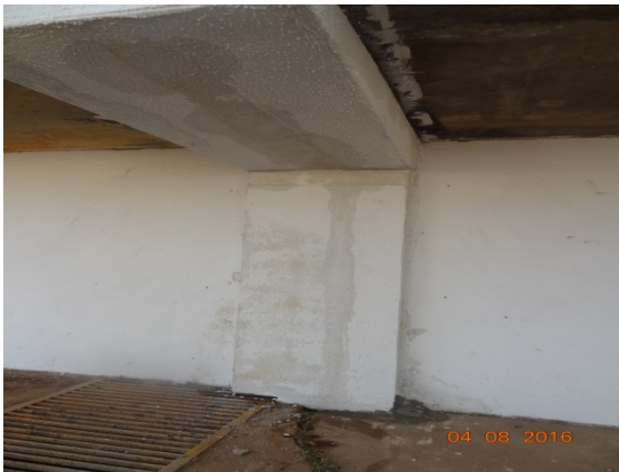
Foto 3 –ETA com infiltração na junção da calha
