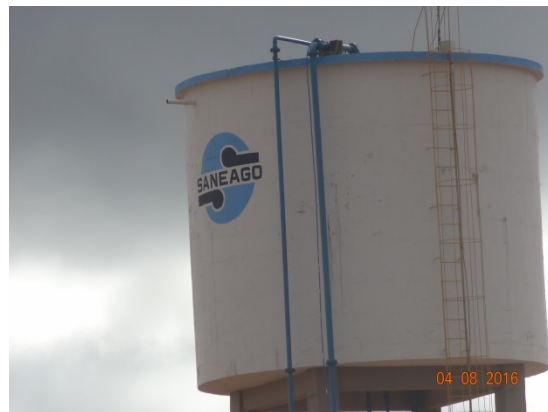
Foto 6 – REL Parque da Colina sem guarda-corpos na cobertura
