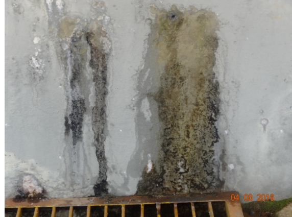
Foto 2 –ETA com eflorações na calha Parshall
