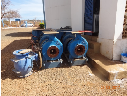
Foto 3 – Trafo e conj. moto bombas
