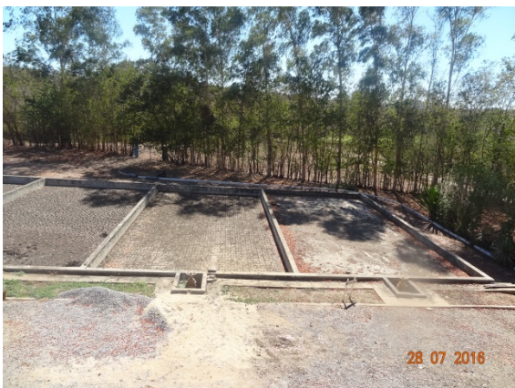
Foto 12 – Leitões de secagem do lodo
