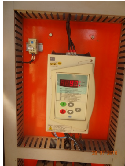
Foto 6 – Sistema de Automação da EEE
