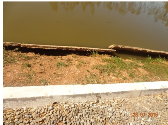
Foto 51 – Placas de contenção da lagoa anaeróbica solta
