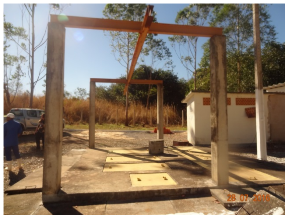
Foto 4 – Poço de sucção da EEE
