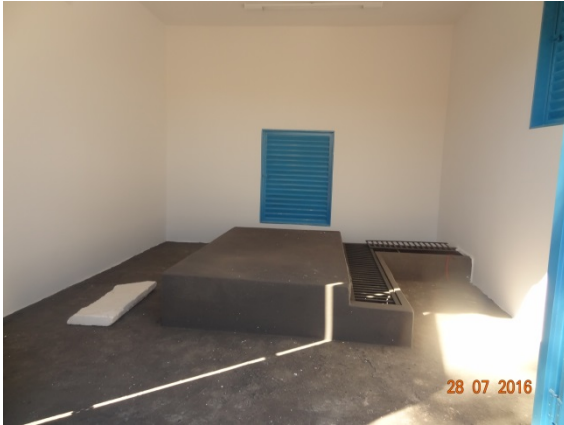
Foto 4 –Local de instalação do grupo gerador na EEE
