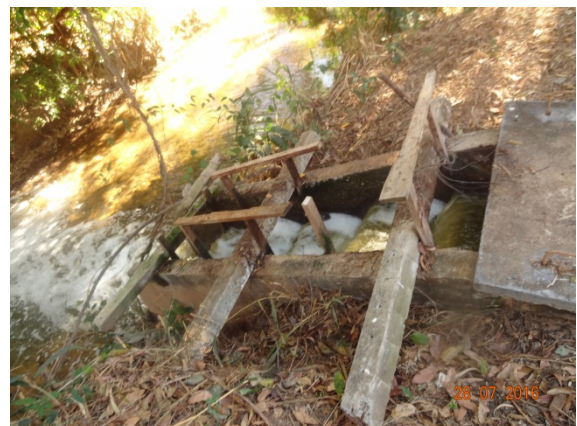
Foto 13 – Ponto de lançamento do efluente final no Córrego Passagem
