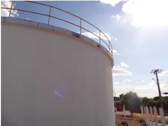
Foto 5 – Presença de perda de revestimento na borda do RAP RII do Cruzeiro.
