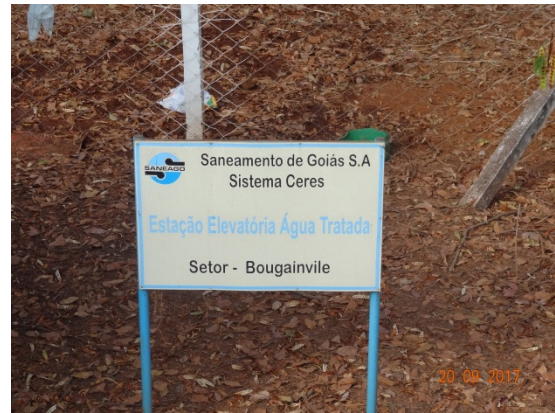
Foto 4 – Inexistência de identificação no Booster Bougainville.
