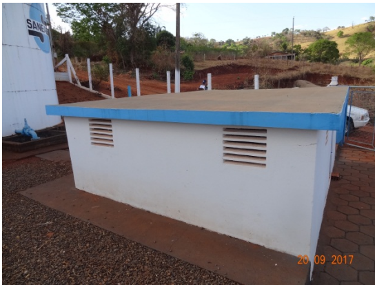
Foto 3 – Pintura desgastada Booster Jd. Tropical.
