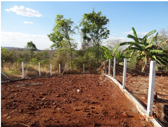
Foto 7 – RAP Sorriso II com cerca de proteção danificada.
