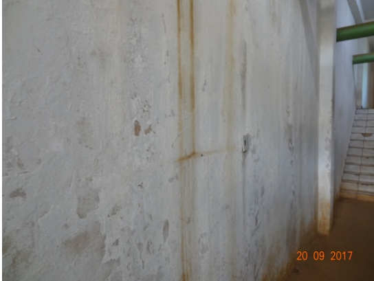
Foto 1 – Presença de infiltrações na galeria dos filtros.
