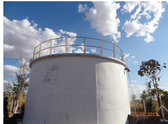
Foto 8 – RAP Sorriso falta de Guarda-corpos.
