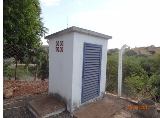
Foto 2 – Pintura desgastada no quadro de comando EEAT Jd. Petrópolis.
