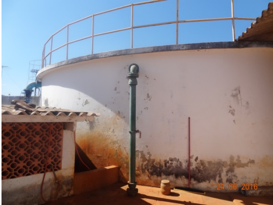
Foto 5 – Pintura desgastada (RAP Distrito)
