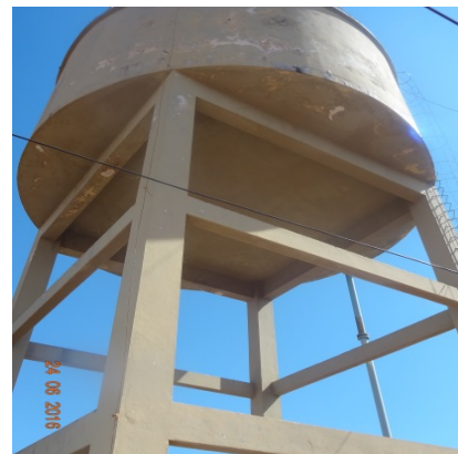
Foto 4 – Pintura desgastada (REL Distrito)
