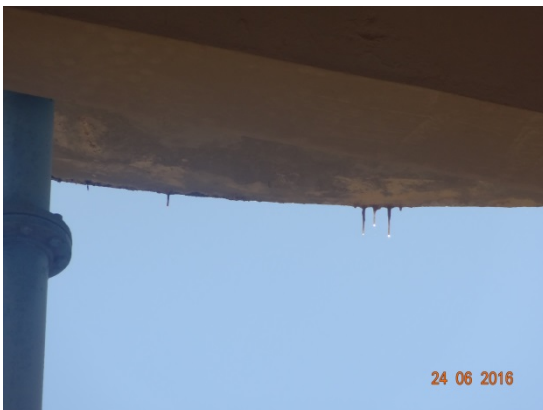
Foto 3 – Infiltrações (REL Distrito)
