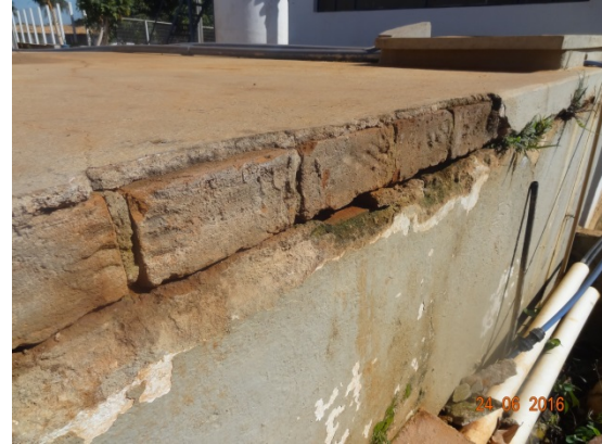
Foto 6 – Perda de revestimento (Caixa de contato) ETA
