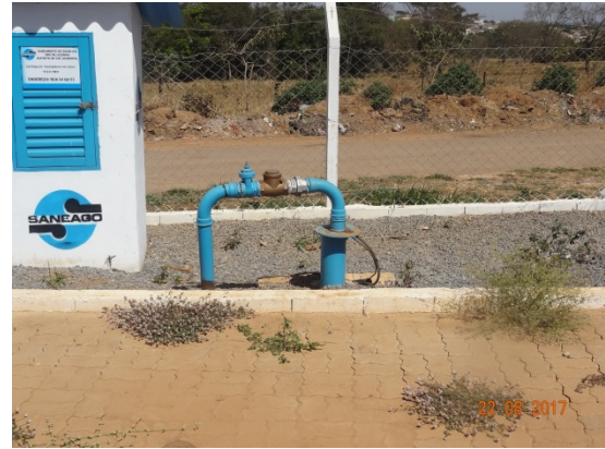
Foto 2 – Poço PMO-05 interligado/Friburgo
