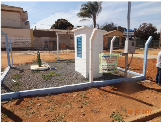
Foto 3 – Poço PMO-06 interligado/Estrela Dalva III
