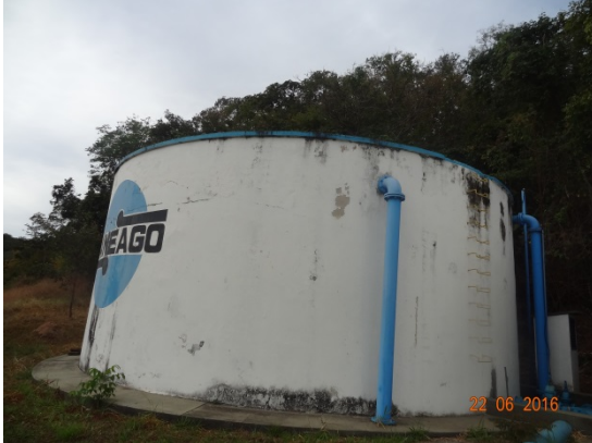
Foto 5 – RAP da Serra R I com pintura desgastada e sem guarda-corpo.
