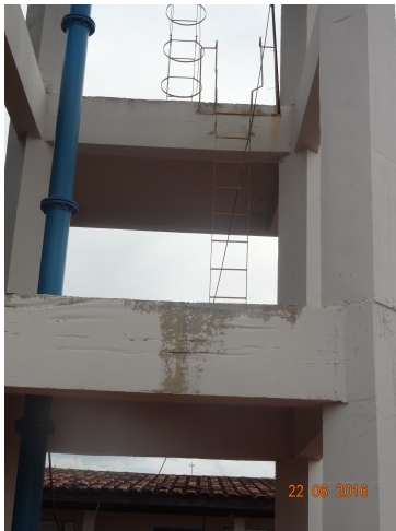
Foto 7 – REL Montes Belos sem guarda-corpos na 1ª parte da escada.
