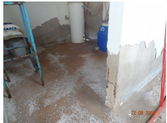
Foto 8 – REL do Aeroporto com perda de revestimento na casa de cloro.
