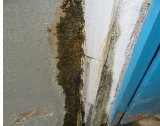
Foto 2 – Infiltrações nos floculadores da ETA.
