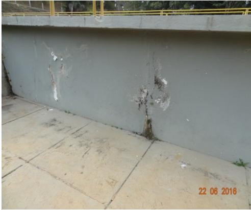
Foto 1 – Infiltrações nas edificações da ETA.
