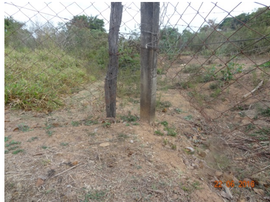
Foto 4 – Poço Quininha I com cerca danificada.
