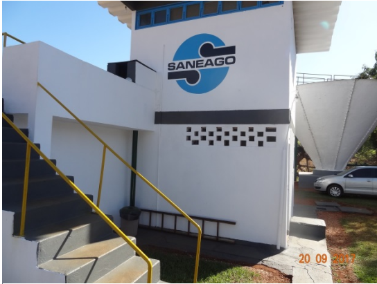
Foto 1 – ETA com presença de infiltrações e eflorescência recuperadas.
