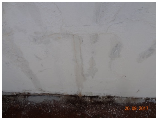
Foto 3 – Infiltrações e eflorescências retornando na ETA
