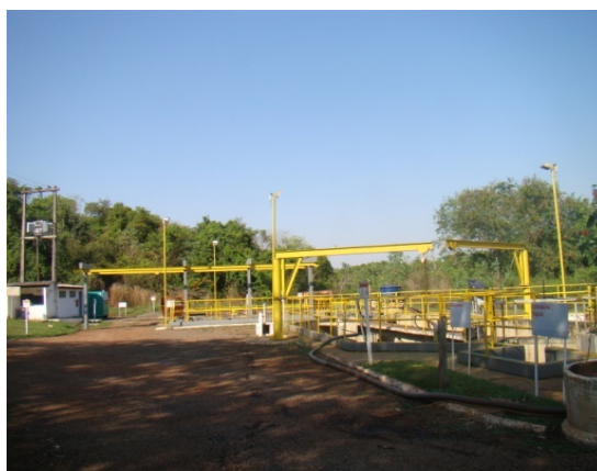
Foto 1 – Gradeamento, caixa de Areia e EEE
