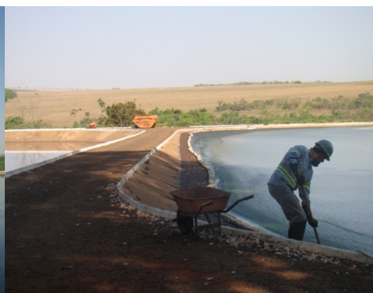
Foto 4 - Sistema tratamento ETE Jataí
