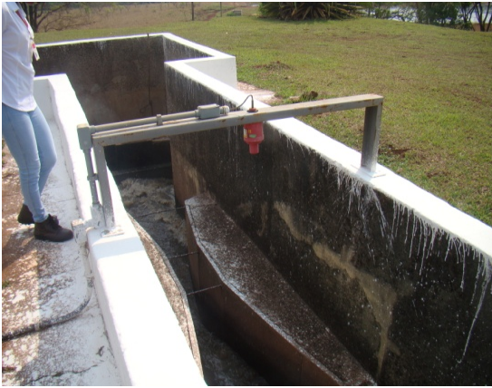
Foto 3 - Calha Parshall - ETE
