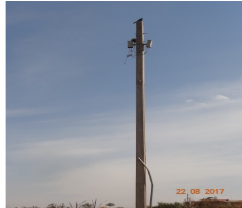
Foto 2 – Poste sem fiação
