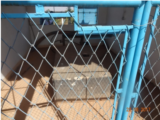
Foto 1 – Base do gerador roubado
