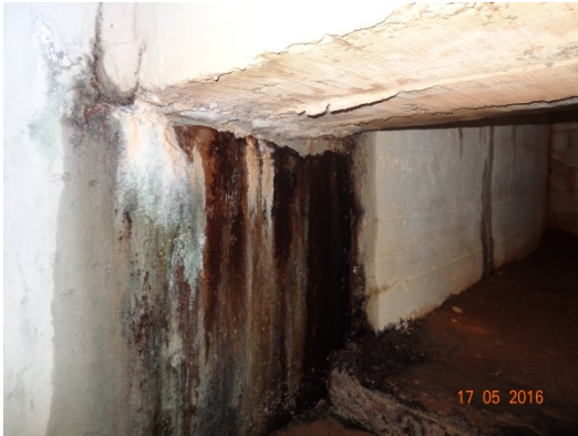
Foto 1 – Infiltração na galeria dos filtros da ETA.
