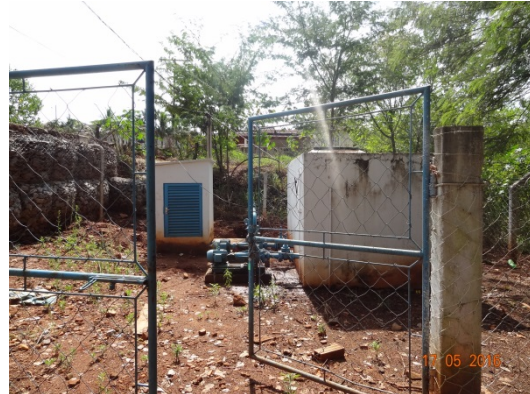
Foto 2 – Ausência de identificação (Booster Bougainville).
