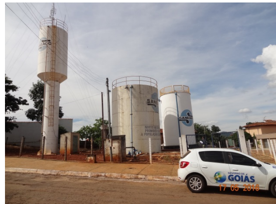
Foto 4 – Abrigo do quadro de comando sem pintura - EEATJardim Petrópolis
