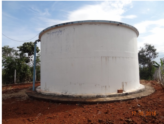
Foto 7 – RAP Sorriso III sem identificação, escada e guarda-corpo
