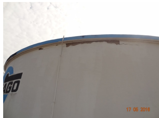
Foto 6 – RAP RII com perda de revestimento
