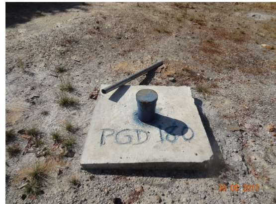
Foto 4 – Poço PGD – 187 no CEMEI.
