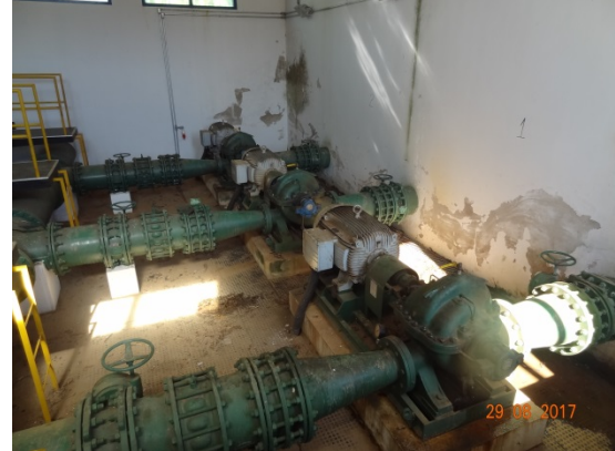
Foto 2 – Conjunto moto-bombas da EEAB/Piancó II.
