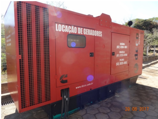
Foto 5 – Grupo gerador locado EEAB/Piarcó II.
