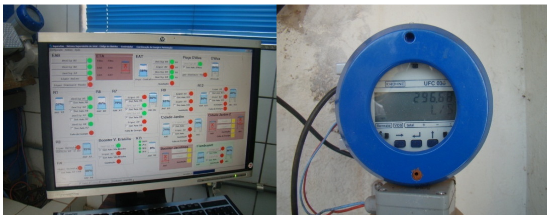
Foto 3 - Painel controle sistema ETAFoto 4 - Vazão - ETA
