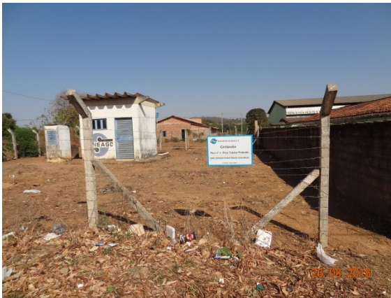
Foto 9 – Poço 3: ausência de portão e pintura desgastada
