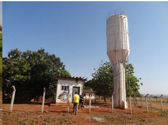
Foto 12 – Res. R1: ausência de portão e vidro quebrado
