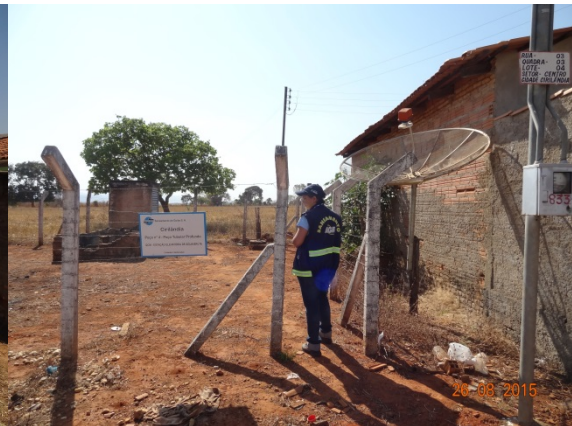
Foto 10 – Poço 4: ausência de portão e pintura desgastada
