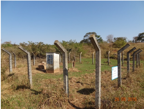
Foto 7 – Poço 1: pintura desgastada, ausência de portão e cerca danificada
