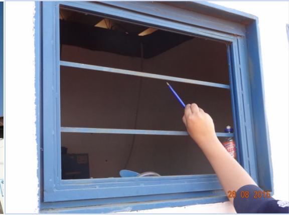
Foto 14 –Res. R2: casa de cloração com vidro quebrado
