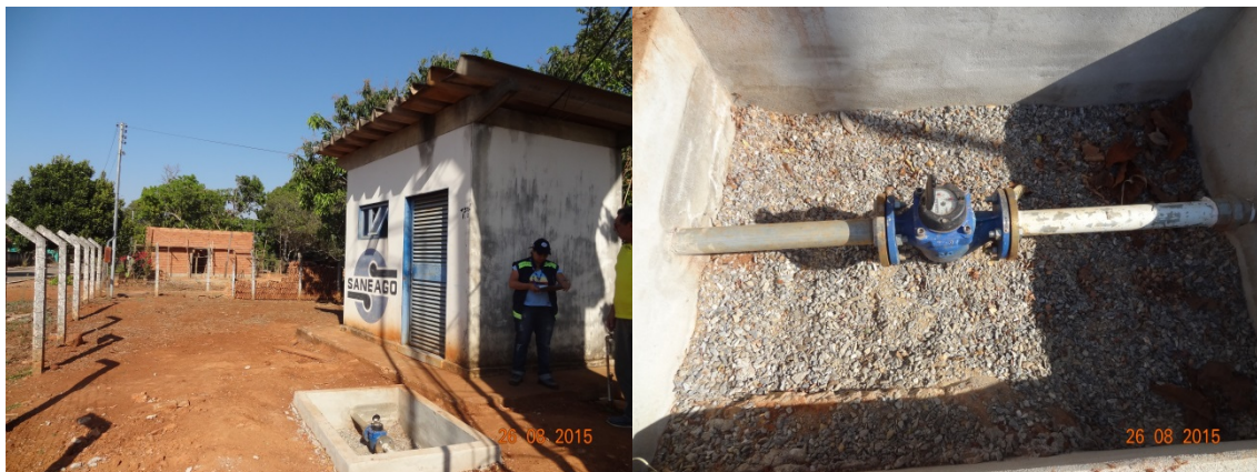
Foto 5 – Res. R1 com macromedidor Foto 6 – Res. R2 com macromedidor
