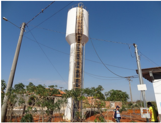
Foto 13 –Res. R2:ausência de portão
