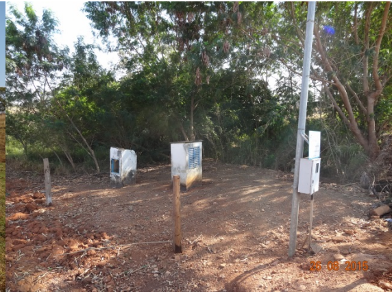
Foto 8 – Poço 2: pintura desgastada, ausência de cerca e portão
