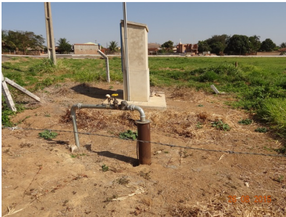
Foto 11 – Poço 5: ausência de pintura,
