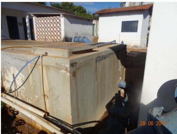
Foto 3 – Tanque de contato com revestimento recuperado.
