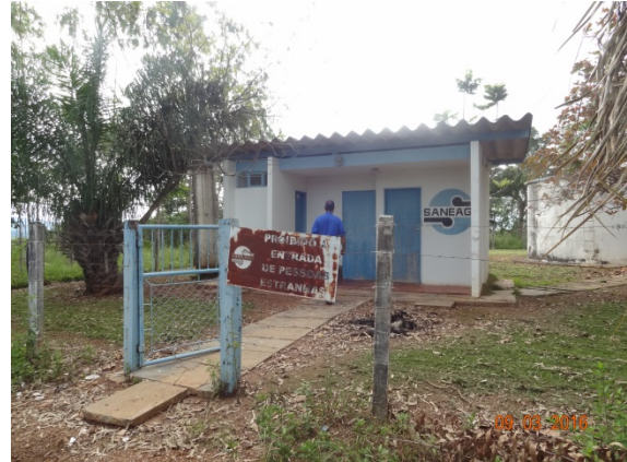
Foto 2 – CR com placa danificada
