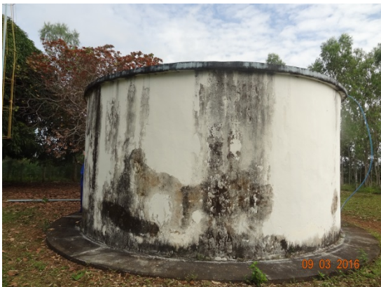
Foto 3 – RAP com pintura desgastada
