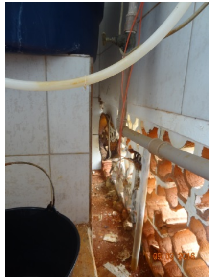
Foto 4 – Casa de cloração com perda de revestimento
