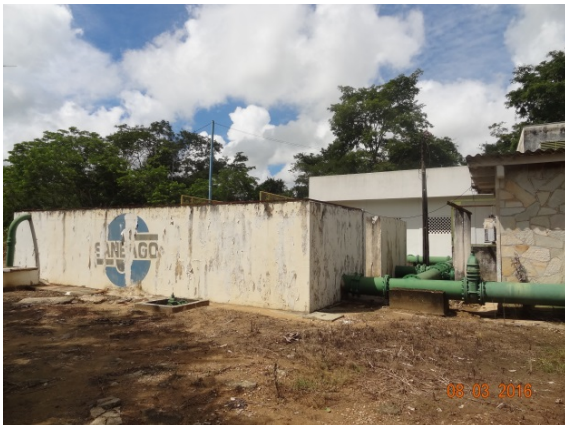
Foto 3 – EEAB/I com pintura desgastada
