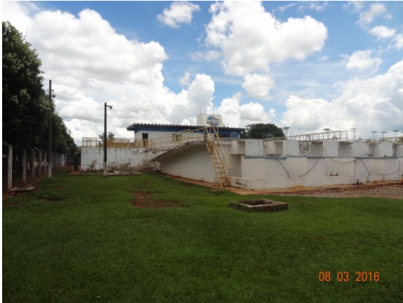
Foto 1 – ETA com pintura desgastada.
