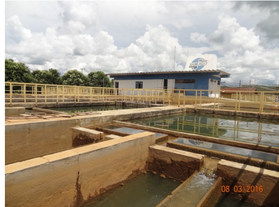
Foto 2 – Ausência de guarda-corpos nos filtros da ETA
