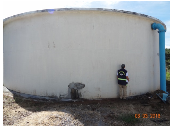
Foto 4 – RAP Morro da Ema (R1) com infiltrações
