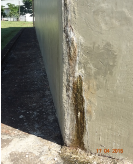
Foto 33 – Res. Ipiranga eflorescência na junta estrutural
