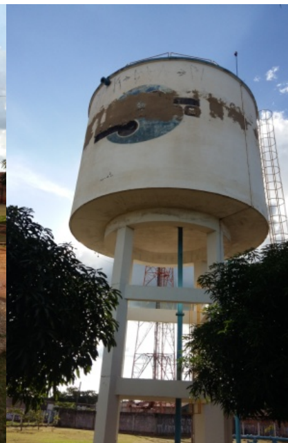
Foto 22 – Res. elevado Jardim Primavera com pintura desgastada
