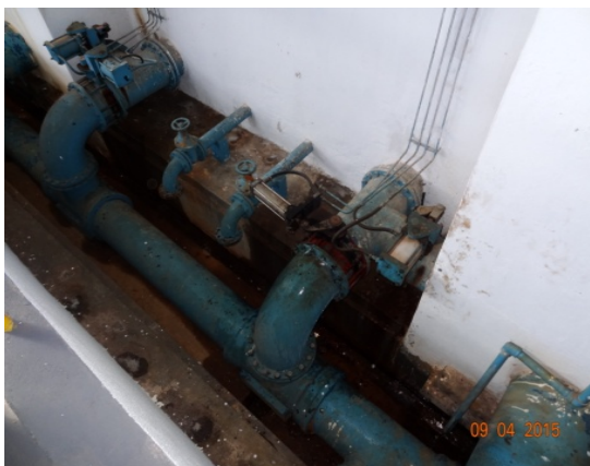
Foto 11 – ETAG - Vazamento registro saída do filtro
