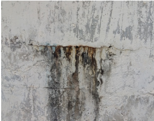
Foto 19 – Res. apoiado Vera Cruz I com eflorescências
