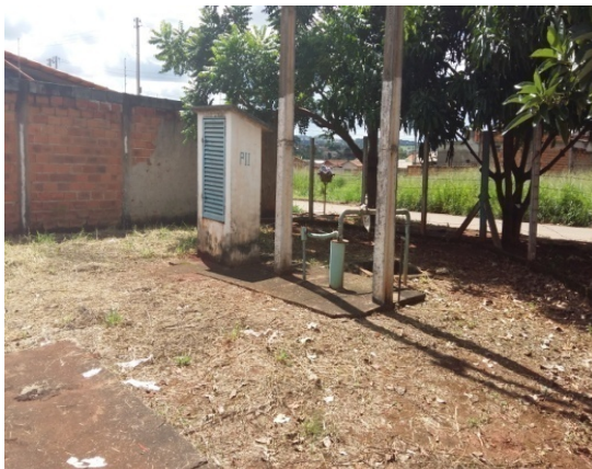
Foto 6 - Poço São Marcos - sem identificação e cerca danificada
