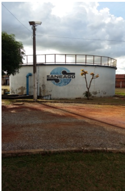
Foto 21 – Res. apoiado Jardim Primavera com pintura desgastada
