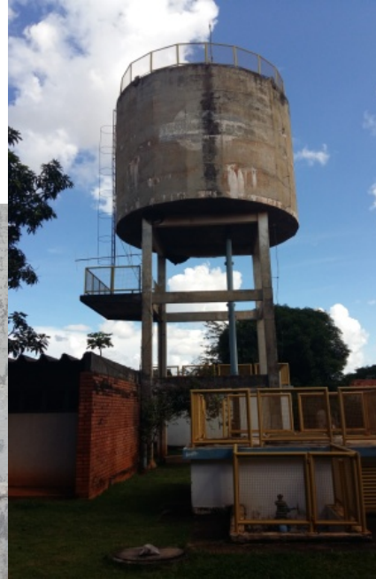
Foto 20 - Res. elevado Vera Cruz I com pintura desgastada
