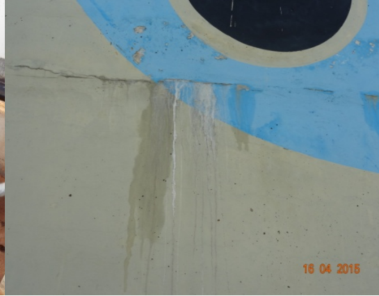
Foto 14 – Res. CR Atlântico - eflorescência em junta reparada
