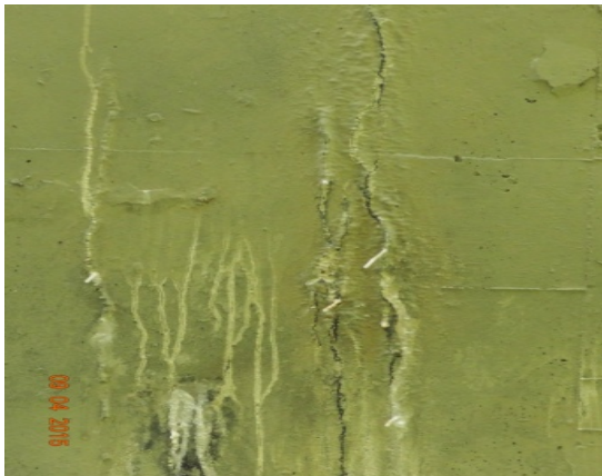
Foto 25 – Res. elevado ETA Samambaia com infiltrações
