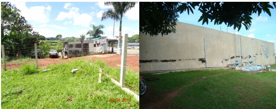
Foto 1 - Vale dos Sonhos - cerca caída Foto 1 - Res. Serrinha sem guarda-corpo
