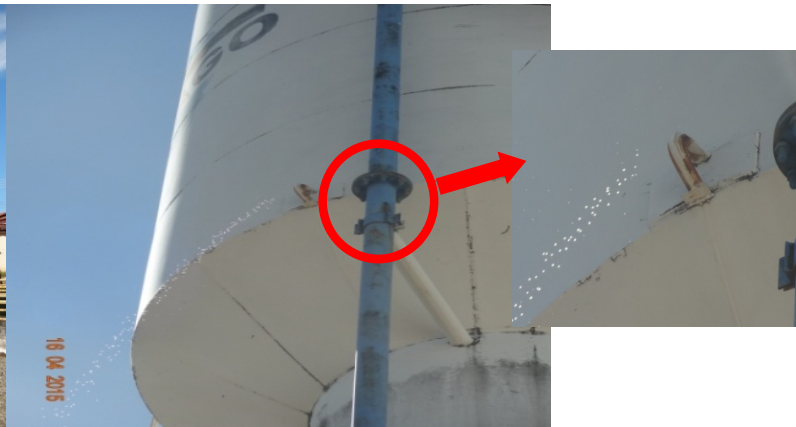
Foto 16 – Res. Campos Dourados - com vazamento no flange
