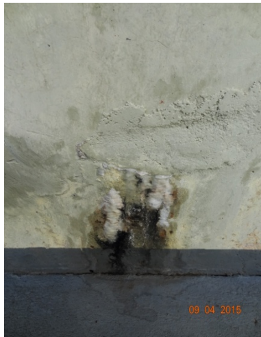
Foto 27 – Res. Guanabara com infiltrações e eflorescências
