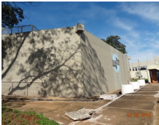
Foto 29 – Res. Mendanha com eflorescências compintura e logomarca desgastada
