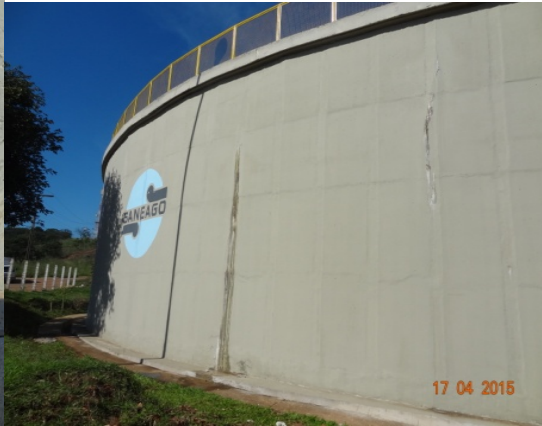
Foto 28 - Res. Mendanha com infiltrações e eflorescências
