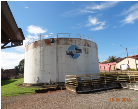
Foto 15 – Res. Oriente Ville - pintura desgastada
