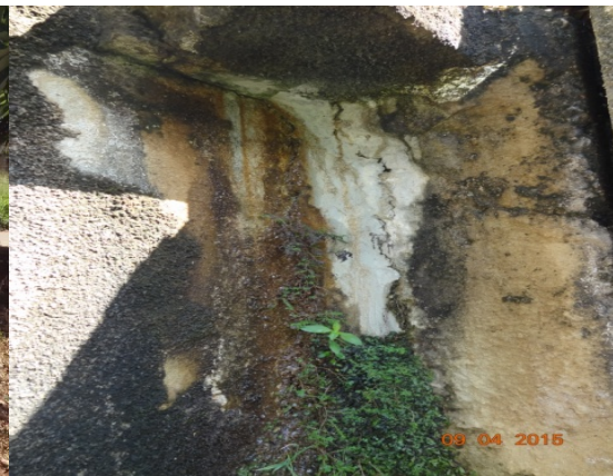
Foto 10 – ETAG - infiltração parede externa do último decantador
