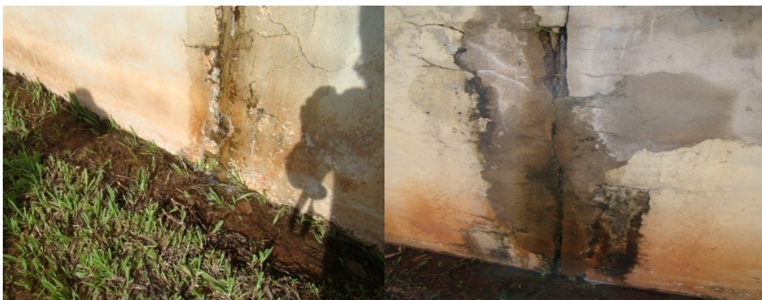
Foto 3 - CELG Res. com vazamentos nas laterais/ juntas do tanque
