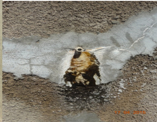
Foto 34 – Res. Novo Horizonte com eflorescências
