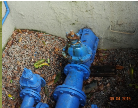
Foto 26 - Res. Itatiaia registro de entrada com vazamento
