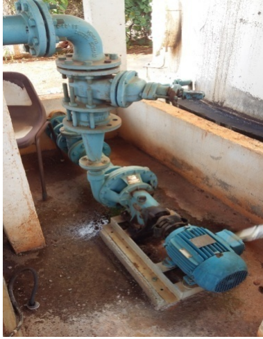
Foto 13 – EEAT São Marcos - vazamento válvula de retenção
