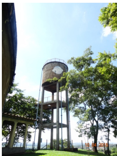
Foto 31 – Res. elevado São Domingos II compintura desgastada e logomarca
