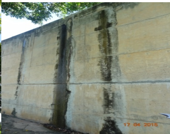
Foto 32 – Res. Cristina com eflorescências
