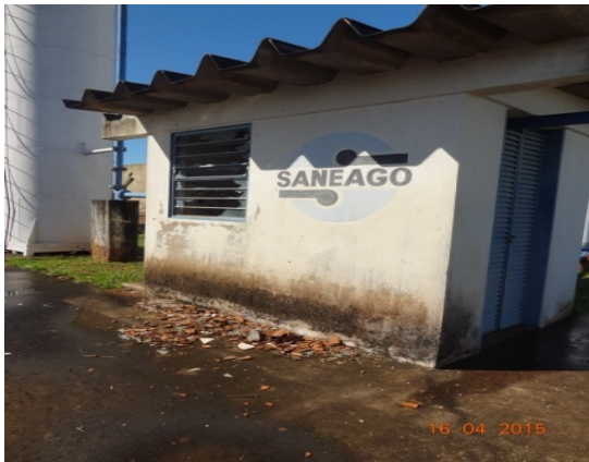
Foto 17 – Janela danificada - edificação Campos Dourados
