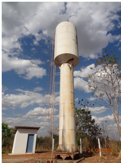
Foto 3 – Res. sem guarda corpos e pintura desgastada
