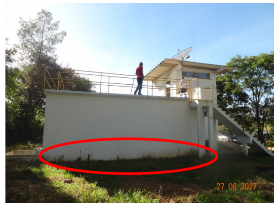
Foto 4 – ETA com novos pontos de infiltrações surgindo.
