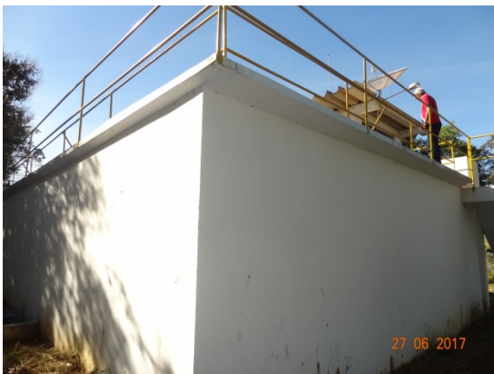
Foto 3 – ETA com infiltrações e eflorações recuperadas.
