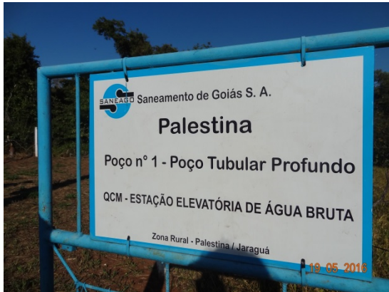
Foto 1 – Poço com identificação.
