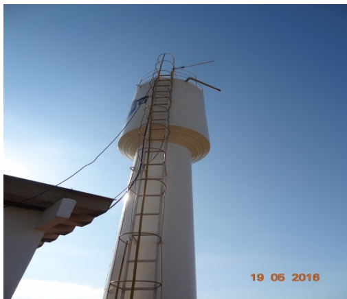
Foto 3 – REL com guarda-corpo.
