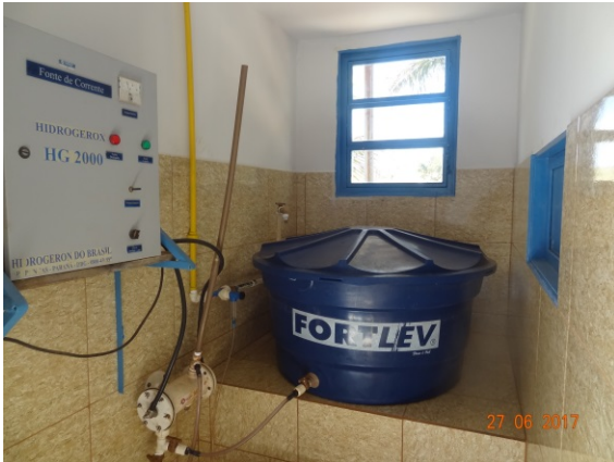
Foto 3 – Sala de hidrogenox revestimento recuperado.
