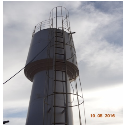
Foto 4 – REL com guarda corpo.
