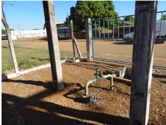
Foto 3– Poço sem laje de proteção
