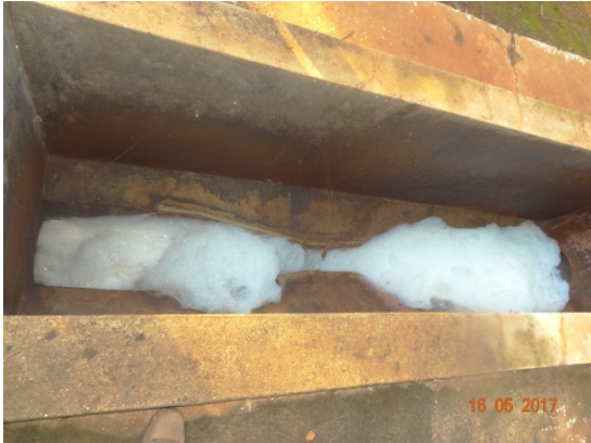
Foto 1 – Excesso de espuma na saída do efluente final
