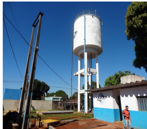
Foto 2 – REL pintura desgastada
