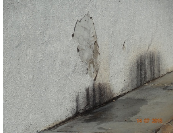
Foto 2 – Parede externa com infiltração
