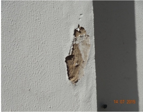
Foto 1 – Perda de revestimento
