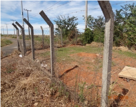
Foto 7 – Sem placa de identificação
