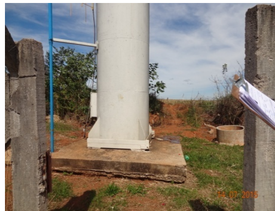
Foto 12 – Ausência cerca de proteção e/ou portão
