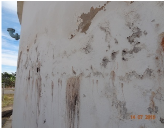
Foto 9 – Presença de eflorescências
