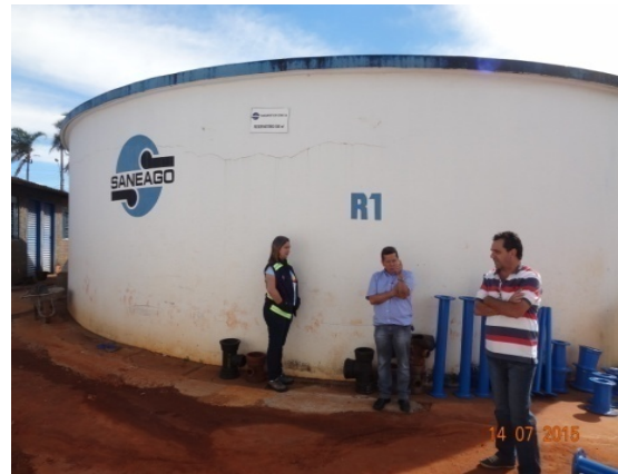
Foto 10 – Res. R1 ausência de guarda-corpos
