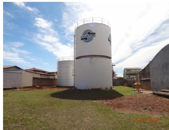
Foto 6 – Sem placa de identificação
