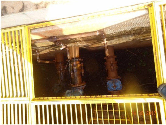
Foto 5 – Vazamento no registro dos reatores (novos)
