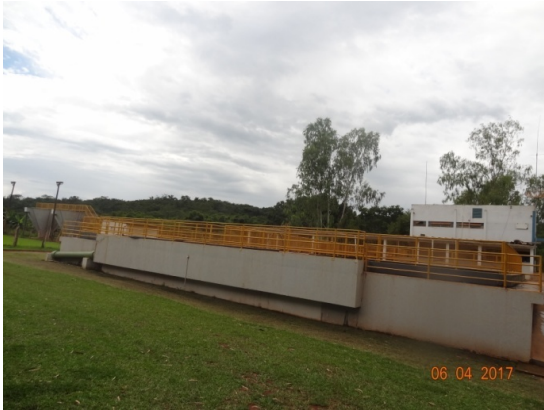
Foto 1 - Edificações da ETA com reparos de trincas, infiltrações e pintura desgastada.
