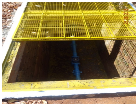
Foto 1 – Macromedidor instalado no local
