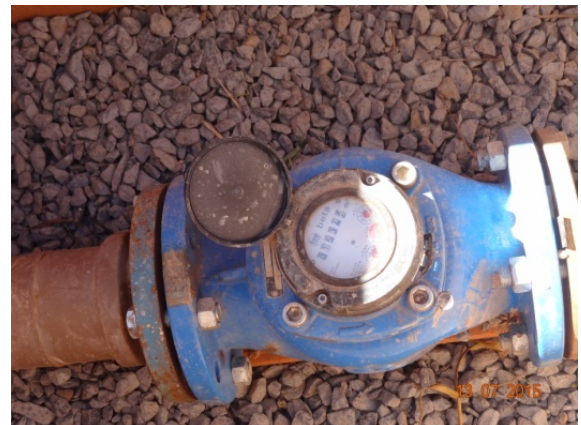
Foto 2 – Macro medidor instalado
