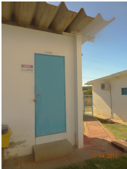
Foto 1 – Sala do clorador com aviso de risco
