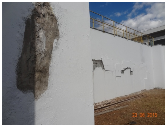
Foto 1- Tratamento das eflorescências - ETA
