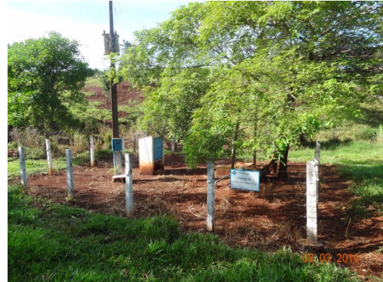
Foto 2 –Abrigo do quadro de comando danificado
