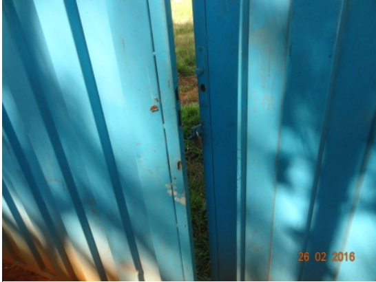
Foto 1 – Suporte do cadeado do portão rompido.
