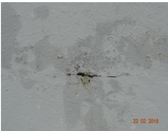
Foto 5 –Infiltrações no RAP R1
