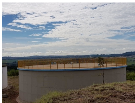
Foto 6 – Reservatório Samarah com guarda-corpo.
