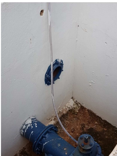
Foto 5 – Medidor de nível no Reservatório Pai Eterno.
