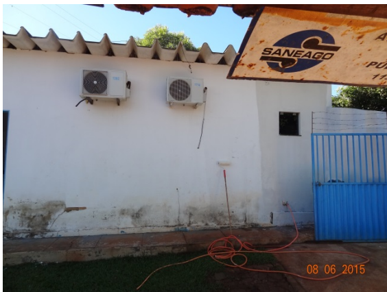
Foto 5 - Perda de revestimento e pintura desgastada
