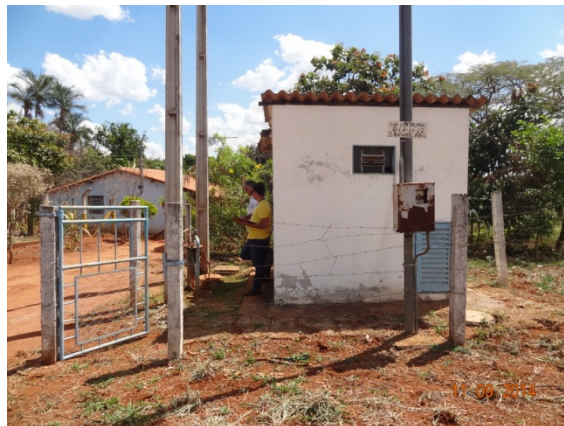
Foto 1 – Inexistência de identificação no poço.
