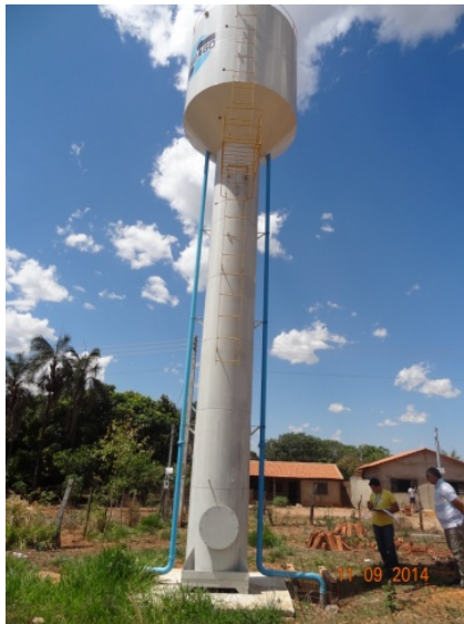
Foto 2 – Ausência de cerca no R1
