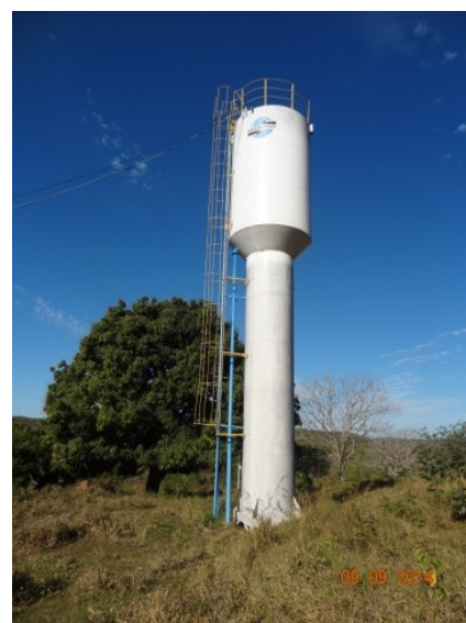
Foto 2 – Ausência de cerca
