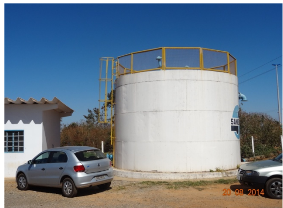
Foto 4 - Res. apoiado 100m 3 - Setor Boa Vista
