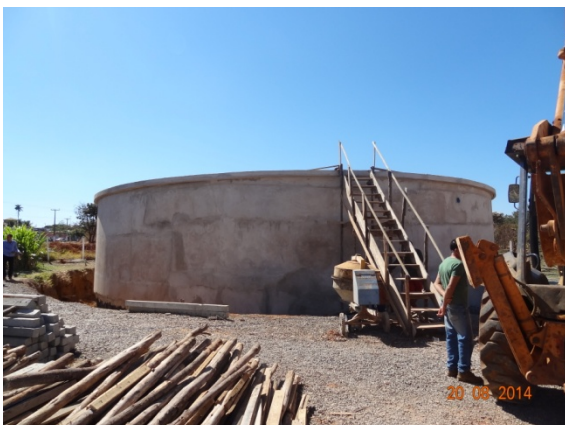
Foto 3 - Res. apoiado 1000m 3 - Setor Boa Vista
