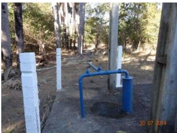
Foto 3 – Poço 17 – Vazão 12 m 3 /h
