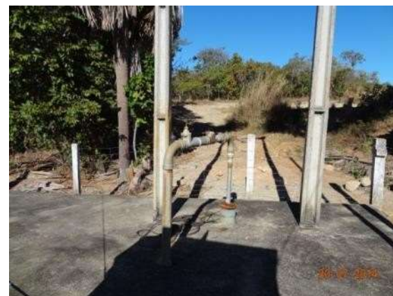
Foto 4 – Poço 09 – Vazão 14 m 3 /h
