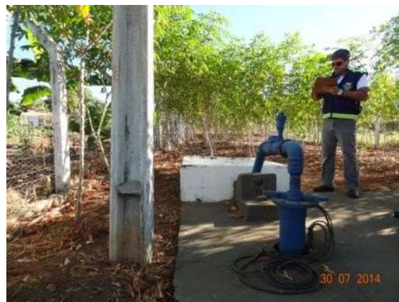
Foto 2 – Poço 02 – Vazão 12 m 3 /h
