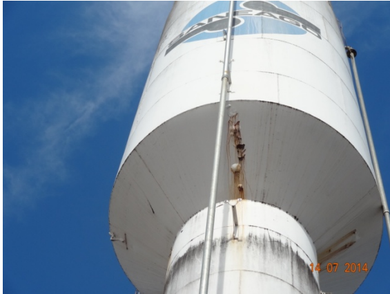
Foto 1 – Reservatório presença corrosão
