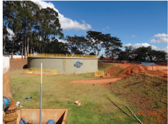
Foto 4 – Novo reservatório já em uso
