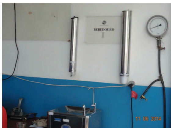
Foto 1 – Placa informativa de bebedouro
