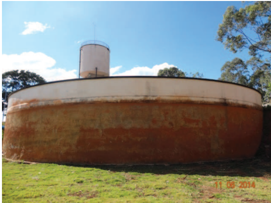
Foto 3 – Res. desativado para manutenção
