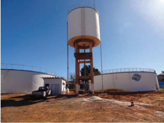
Foto 1 – Pintura restaurados - Res. Cruzeiro
