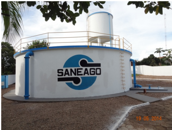
Foto 3 – Eflorescência tratada – Reservatório Semi-enterrado.
