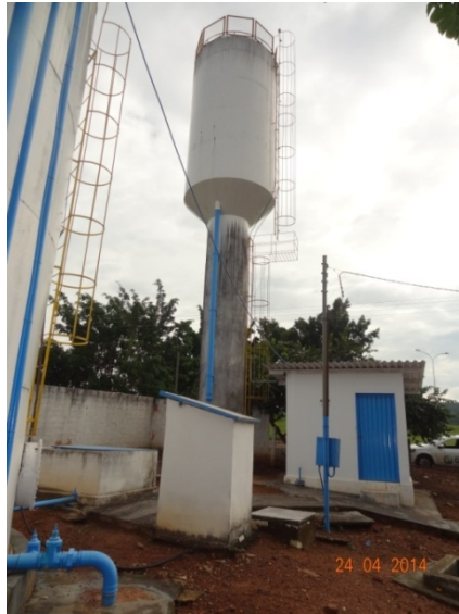
Foto 3 – Reservatório Elevado pintura desgastada e guarda-corpo instalado
